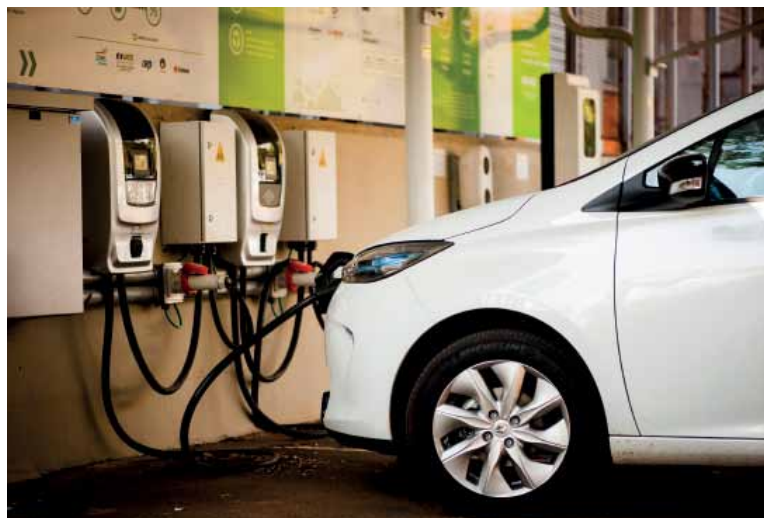
Laboratório de Mobilidade Elétrica do CPqD e da CPFL Energia, em Campinas: avaliação de pontos de recarga
