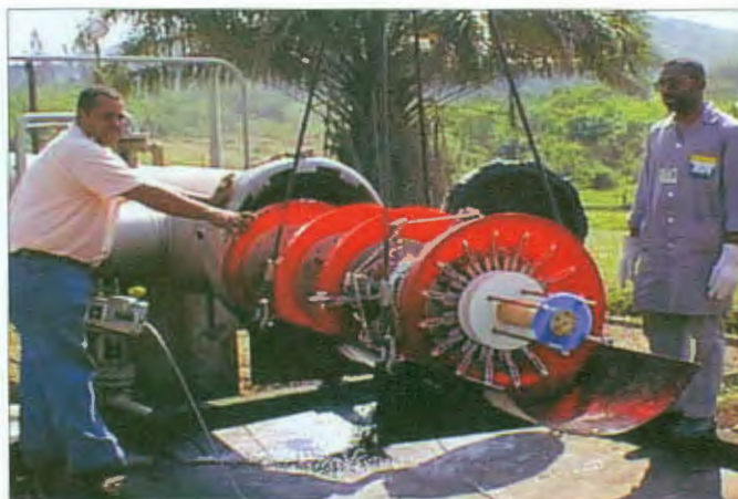
Pig geométrico: verifica irregularidades no interior dos dutos
