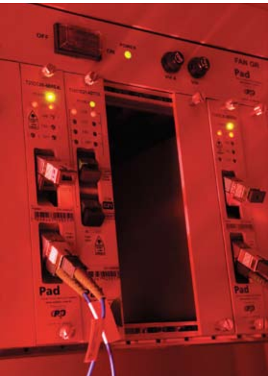
Mackenzie: conexão das fibras ópticas
