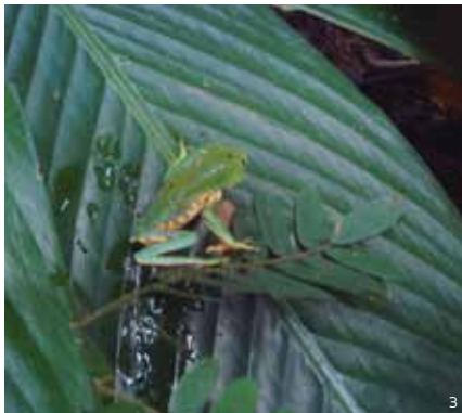
À frente dos tratores: corte da mata baixa e resgate de plantas e animais; bromélias e orquídeas coletadas e mantidas em viveiros; e perereca de uma das áreas da futura estrada
