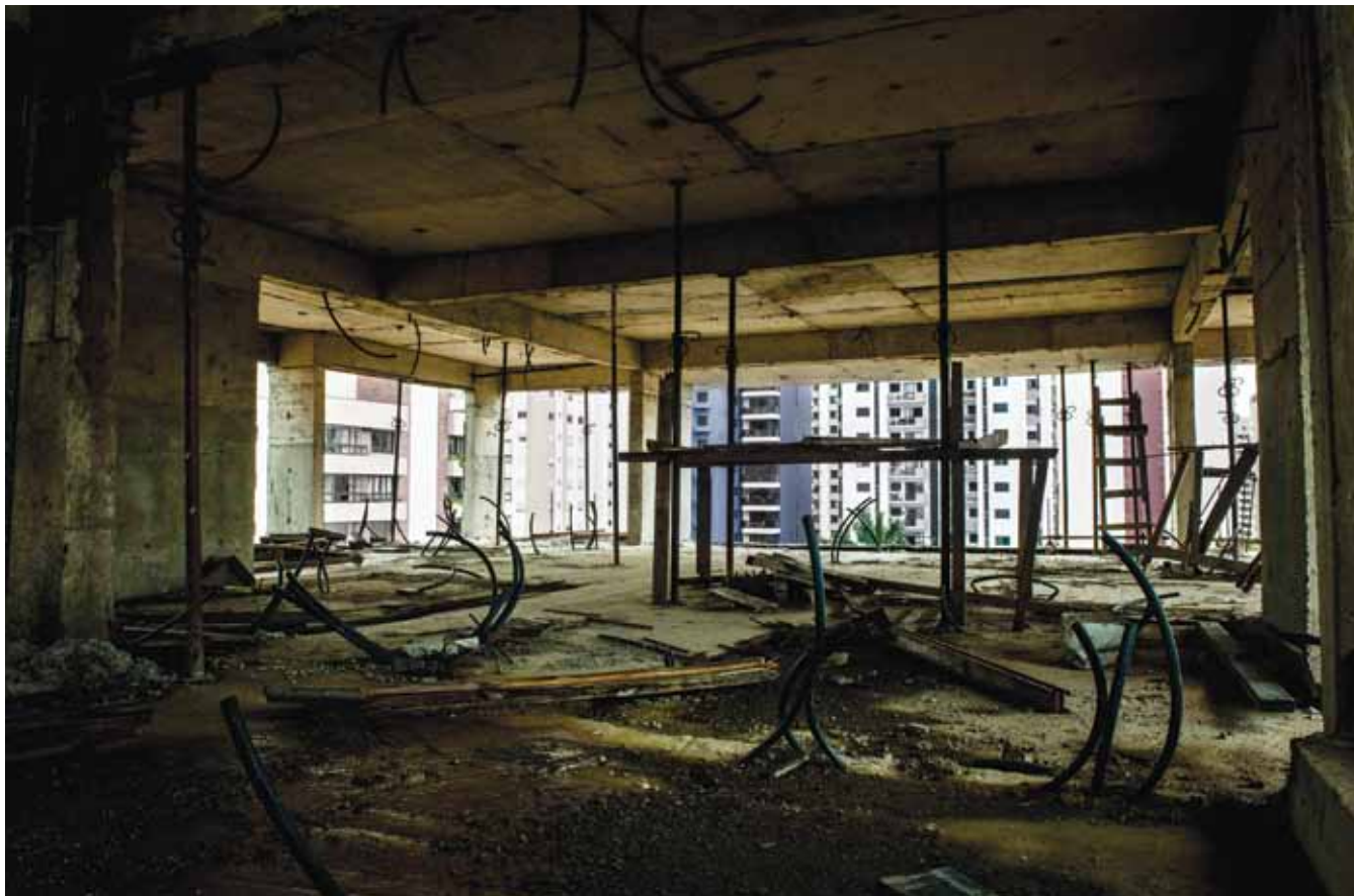
Esqueleto de prédio na Vila Leopoldina, zona oeste de São Paulo, em primeiro plano. Ao fundo, prédios novos que surgiram durante o boom imobiliário dos primeiros anos deste século
