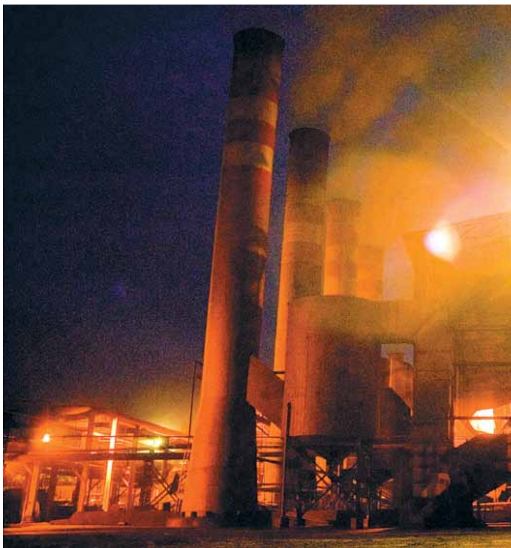
Las calderas de Usina Santa Elisa, en Sertãozinho (São Paulo): la producción de energía eléctrica se efectúa con bagazo de caña
