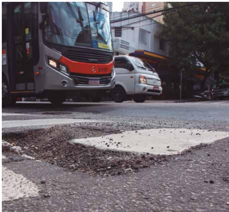
Un bache en la calle: la falta de mantenimiento preventivo es una de las causas de la mala pavimentación urbana en Brasil
