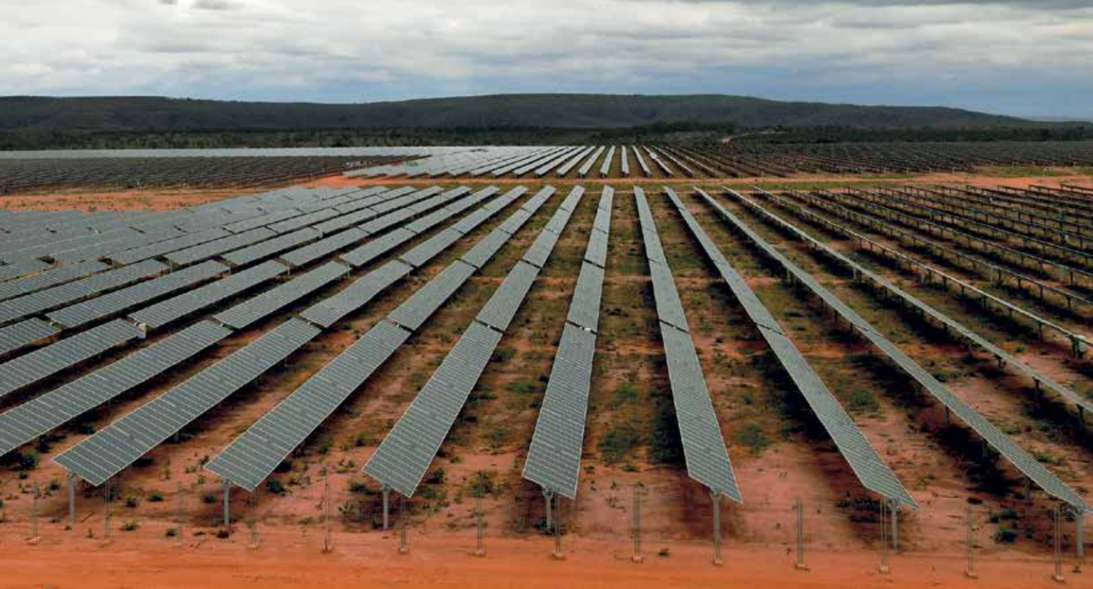
Usina de energia solar em Pirapora, Minas Gerais, uma das maiores da América Latina
