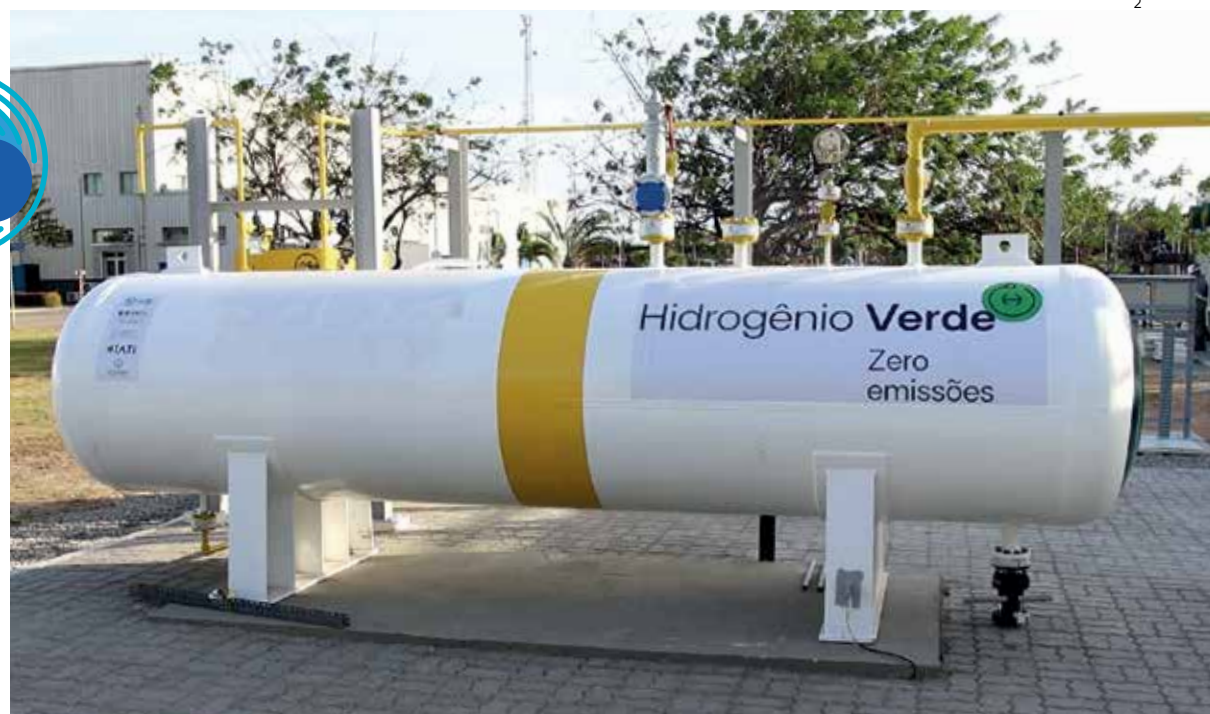
Usina-piloto da EDP no Complexo Termelétrico do Pecém, no Ceará
